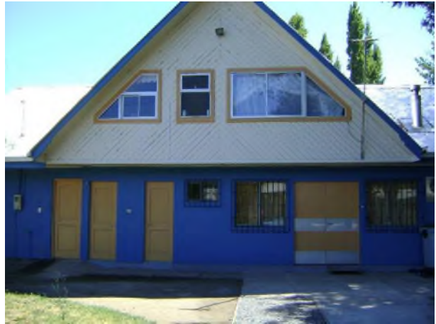
Reparación de vano sobre marco de madera y reposición de ventanas 2º nivel
